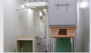
اختبار تدفق الهواء Air flow testing
